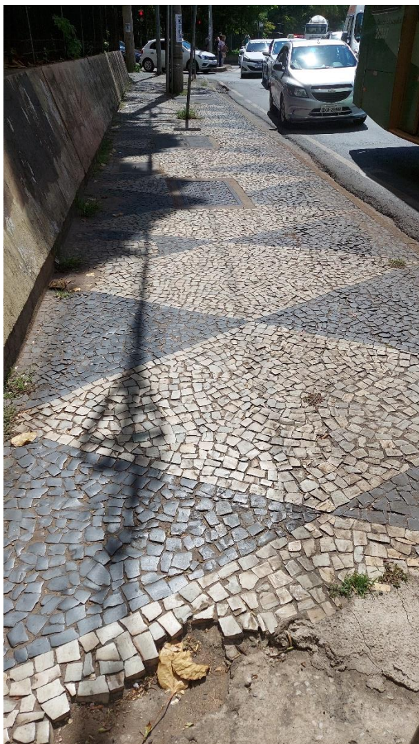
Sede DER-MG. Detalhe do passeio em pedras portuguesas, demandando manutenção para recomposição da paginação. Fonte: DIPIC, 2023.
