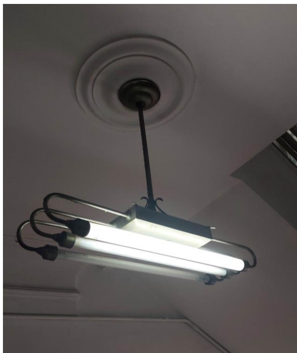
Sede DER-MG. Edifício “A”, variação de luminária pendente com três lâmpadas tubulares dispostas horizontalmente. Fonte: DIPC, 2023.
